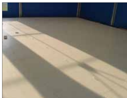
Gotowa tafła lodowiska z widocznym kolkowaniem
