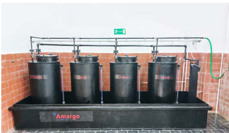
Zbiorniki z tworzyw sztucznych laminowanych na nieczystości ciekłe laboratoryjne oraz na ścieki niskoaktywne
