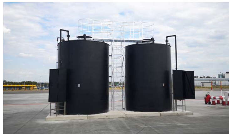
Zbiorniki z PE100 po 24 m 3 każdy do magazynowania gazu Clariant
