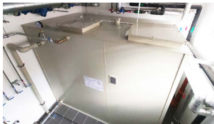
Zbiornik magazynowy wody pitnej dla ośrodka zdrowia
