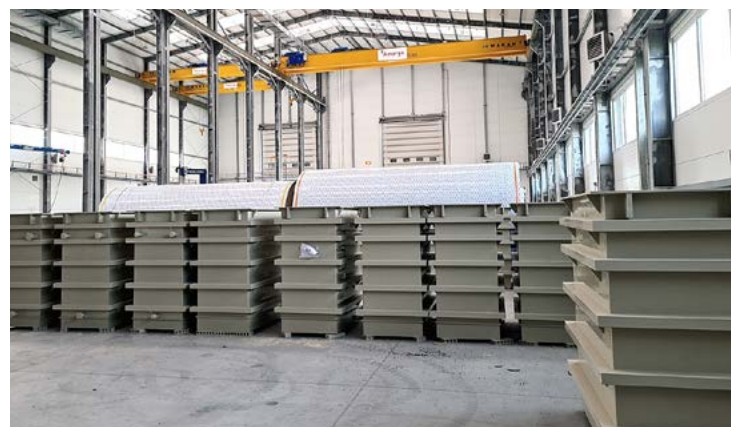
Zbiorniki procesowe (wanny trawialnicze) z wyposażeniem i orurowaniem zautomatyzowanej linii produkcyjnej elementów metalowych
