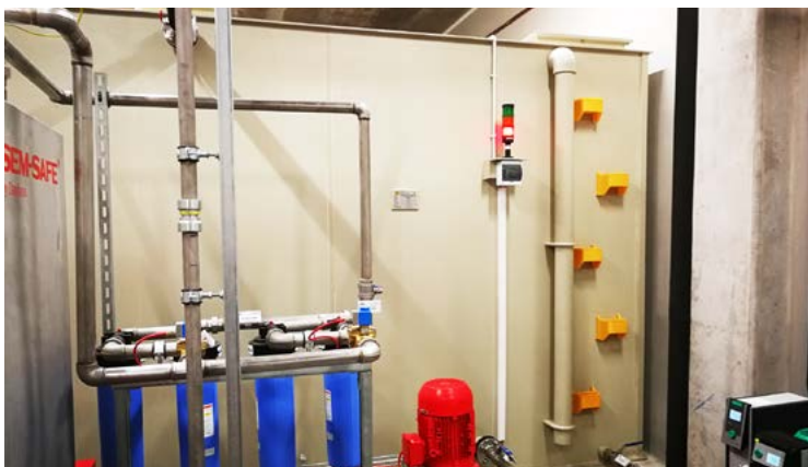
Zbiornik przeciwpożarowy dla budynku archiwum
